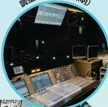
調整室 (音響・照明)
